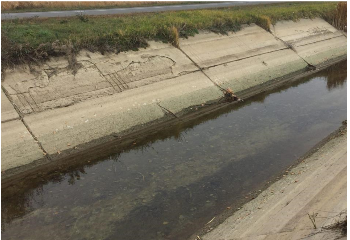
Рисунок 3.20 – Дефекты на поверхности бетонной облицовки мелиоративного канала
