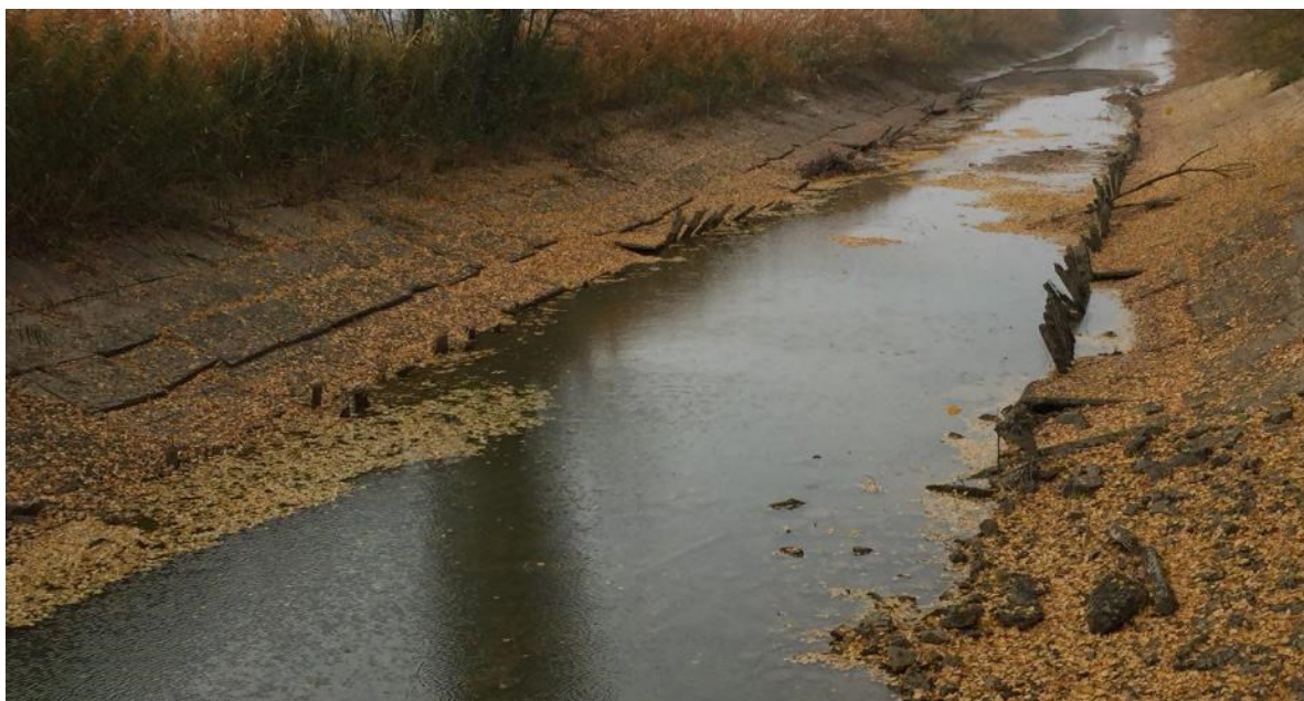
Рисунок 3.13 – Общий вид Багаевского МК с дефектами в виде оползания, разрушения поверхности бетонных плит и зарастания канала камышом
