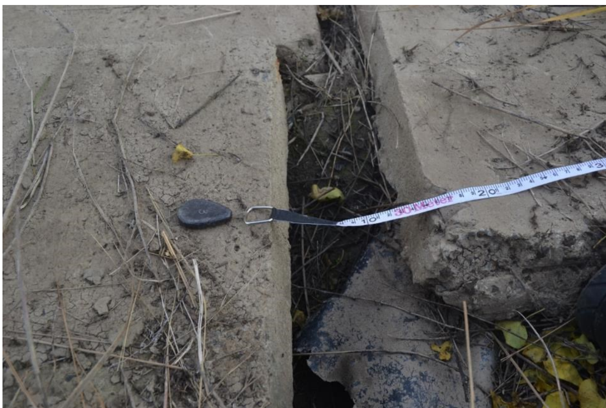
Рисунок 3.16 – Смещение бетонной облицовки, повлекшее раскрытие деформационного шва и оголение противофильтрационной пленки
