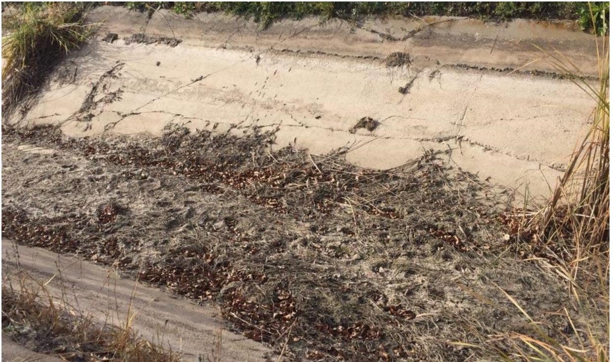
Рисунок 3.21 – Общий вид распределительного канала до проведения очистки ложа и откосов для ремонта повреждений
