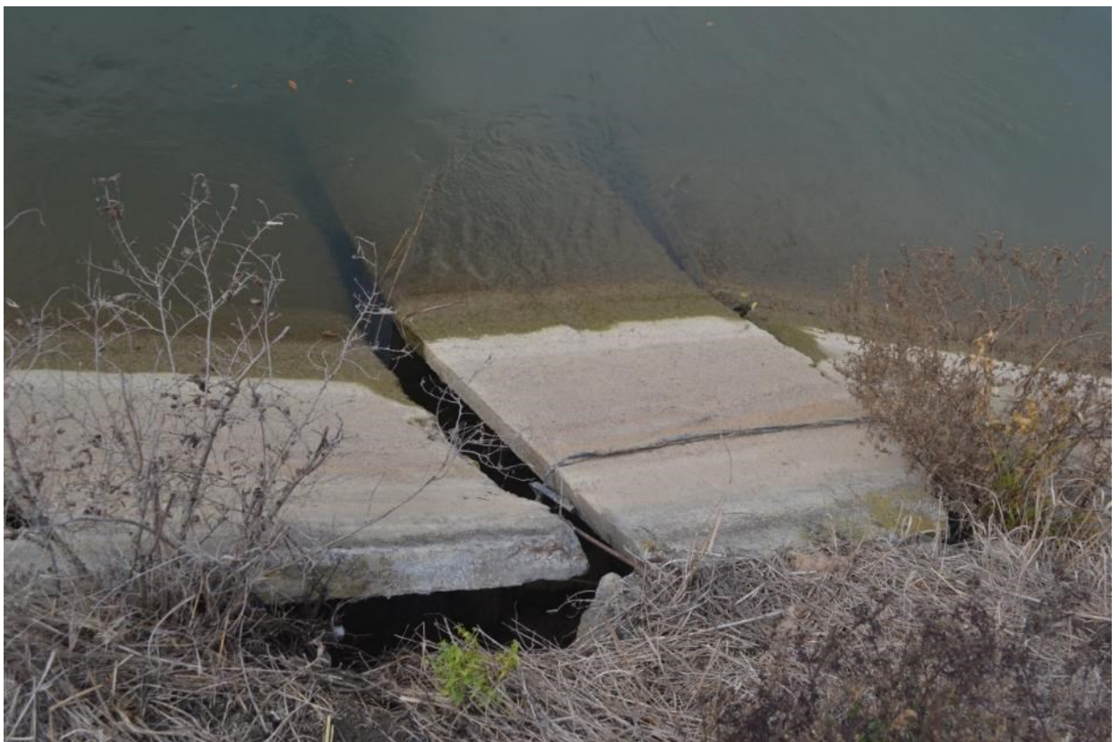
Рисунок 3.18 – Вымывание грунта из-под плиты, смещение бетонной облицовки
