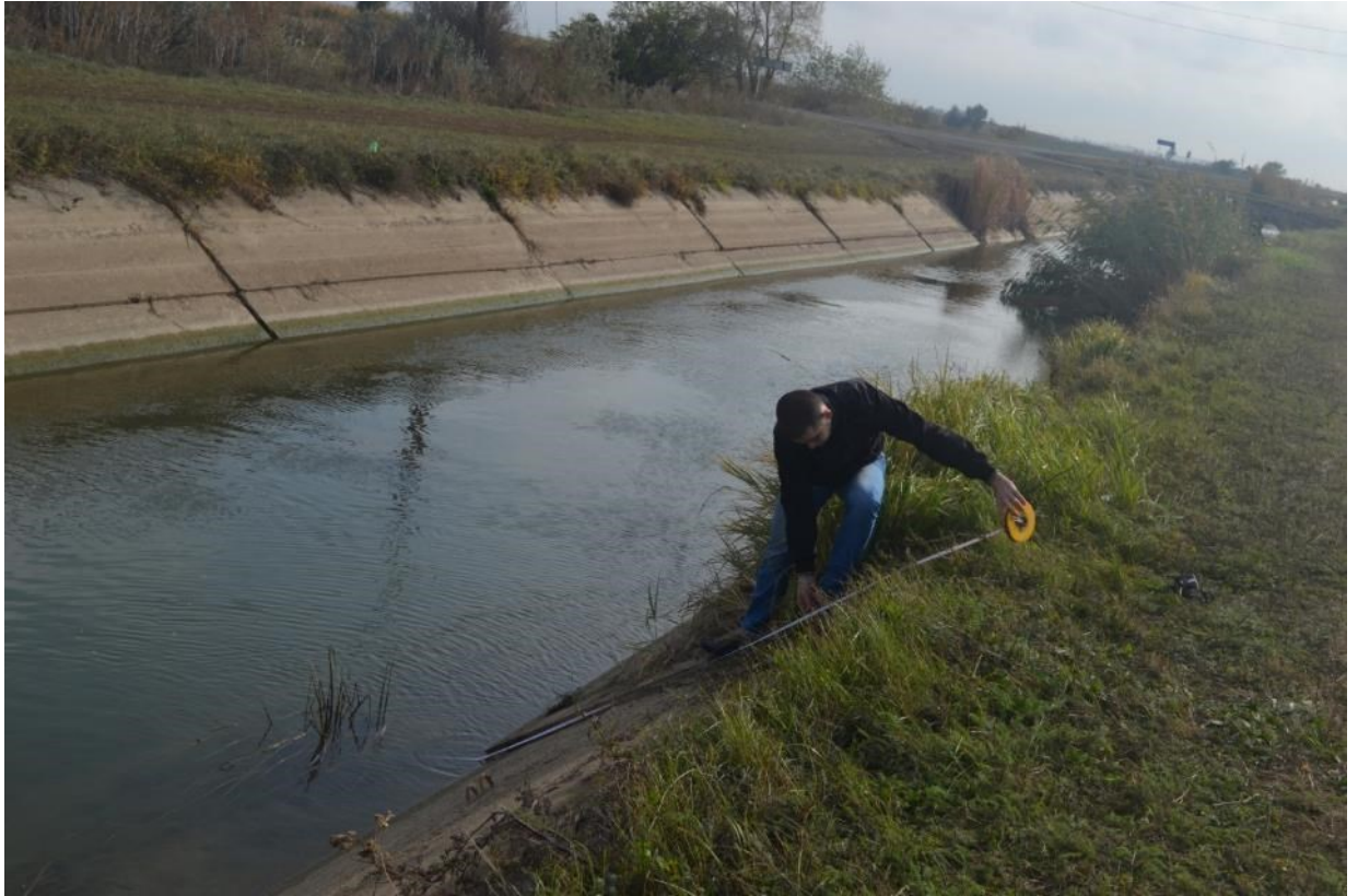
Рисунок 3.19 – Измерение смещения бетонной облицовки на откосе канала
