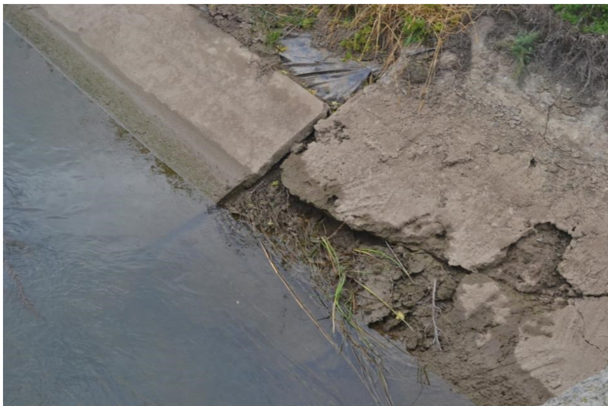
Рисунок 3.15 –Разрушение бетонной облицовки канала, оголение противофильтрационной пленки
