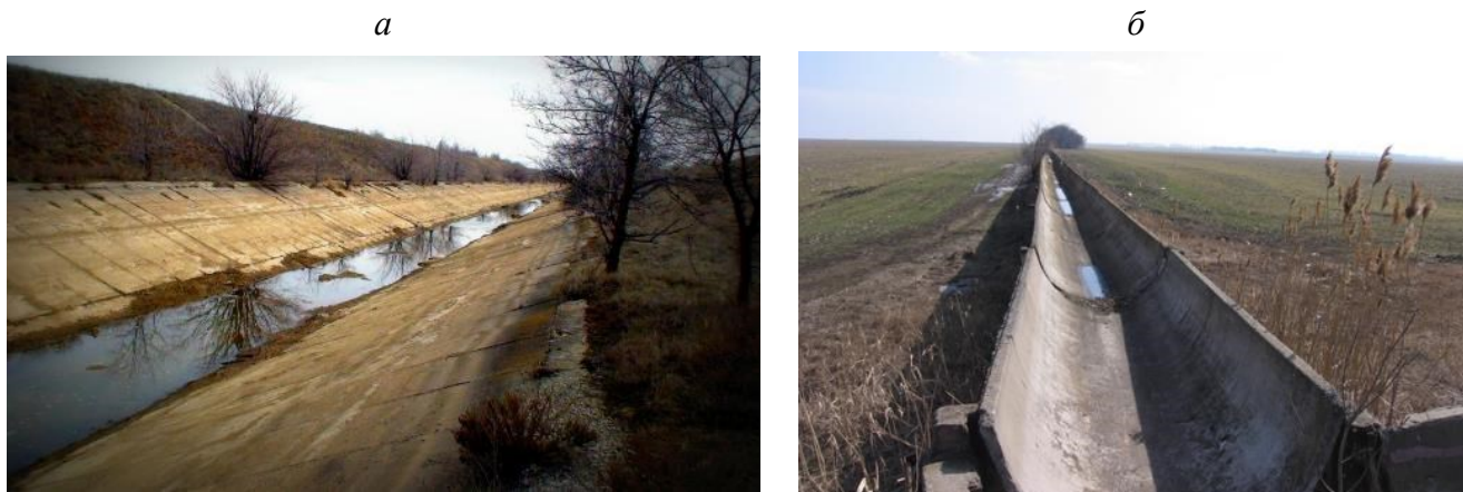
а – оросительного канала в облицовке; б – лоткового канала со сборными секциями Рисунок 2.1 – Техническое состояние каналов и лотков при длительной эксплуатации (более 30 лет)
