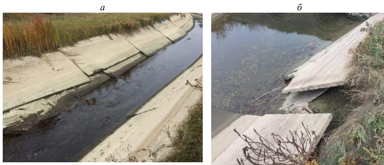
а – текущее состояние распределителя; б – повреждения
